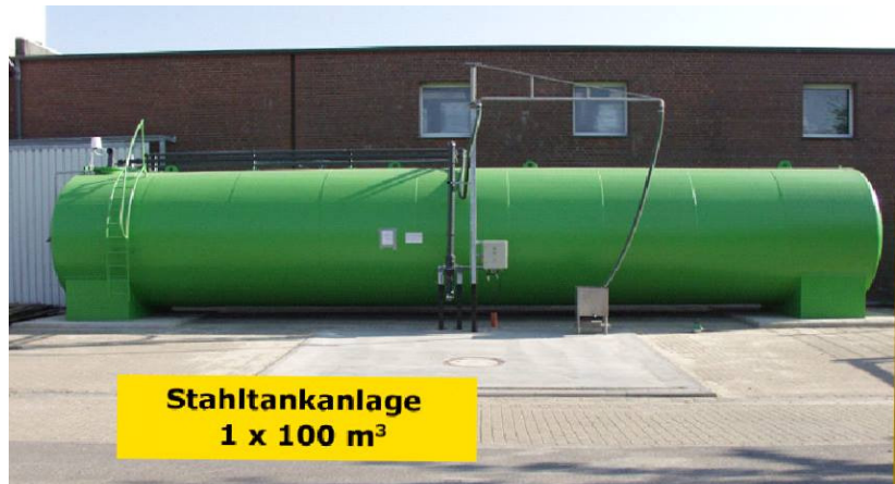
DIN-Stahlbehälter mit Leckschutzauskleidung und Abfüllplatz; Anfahrerschutz erforderlich [Quelle: Geschwill]
