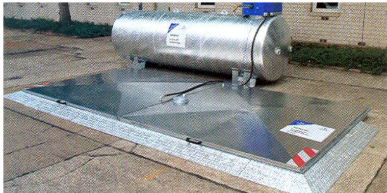
Tankstelle mit Abfüllplatz (mit ABZ); Anfahrerschutz erforderlich)
