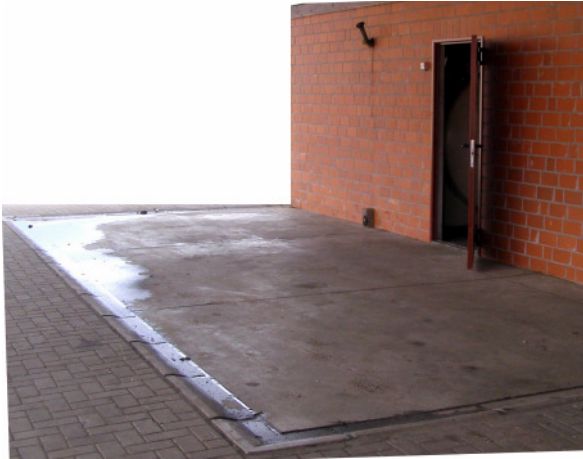
Überdachter Abfüllplatz einer Eigenverbrauchstankstelle, Lagertank im Gebäude
